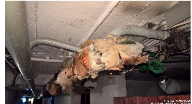
Rohrisolierung aus alter Mineralwolle
